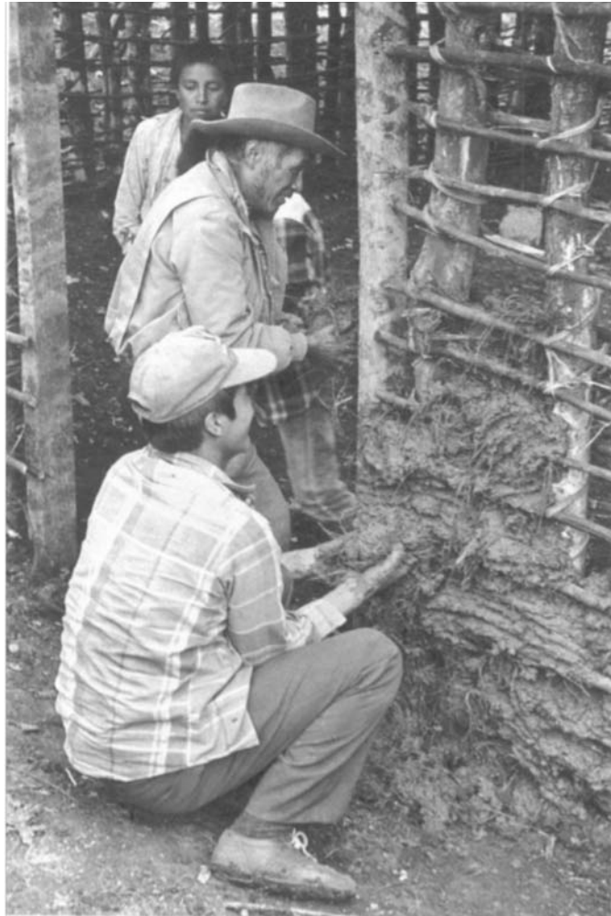
Construyendo una casa de bajareque en Ch'imban De: Shamans, Witches & Maya Priests de Krystyna Deuss, © Guatemalan Maya Centre, London
