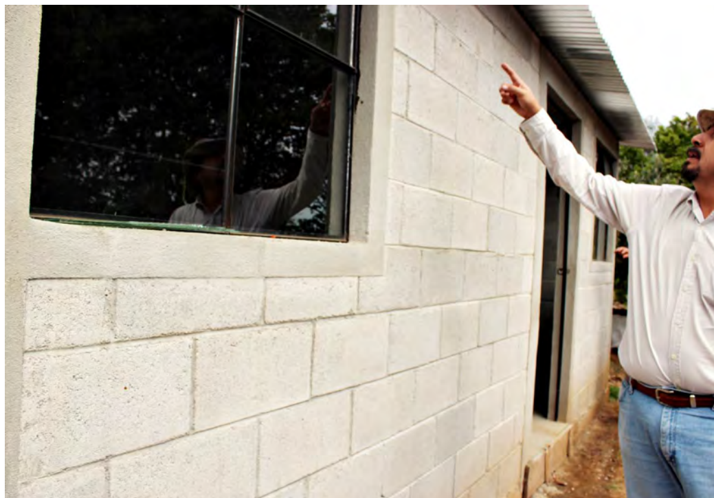
Evaluación de viviendas construidas antes del 2012 en Zaculeu, Tecpán, Chimaltenango. 17-02-2012
